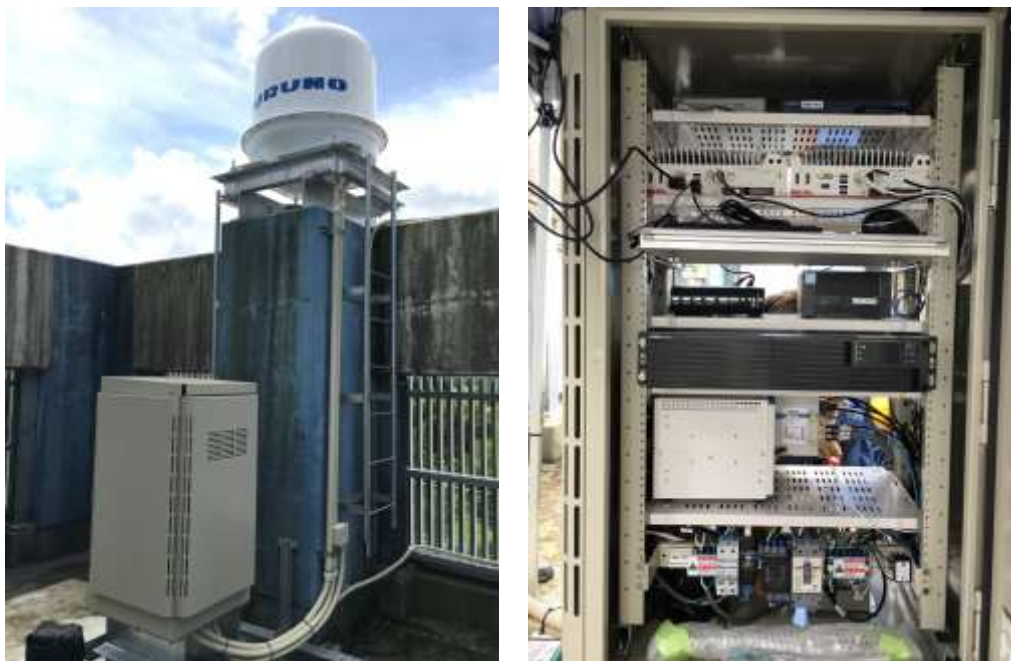
図3 レーダーの設置状況。霧島市立牧園中学校に設置したもの。
